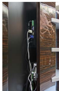
もう一つのケースにはセットトップボックスとワイヤレスLANのモデムがセットされている。このボックスとディスプレイは、床下に通されたケーブルで接続されている。
